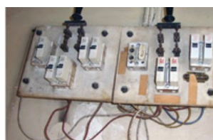
Conformité de l'électricité
